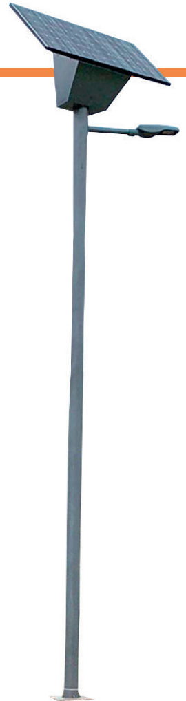
Un dels fanals solars que s'han instal·lat a la zona esportiva.
